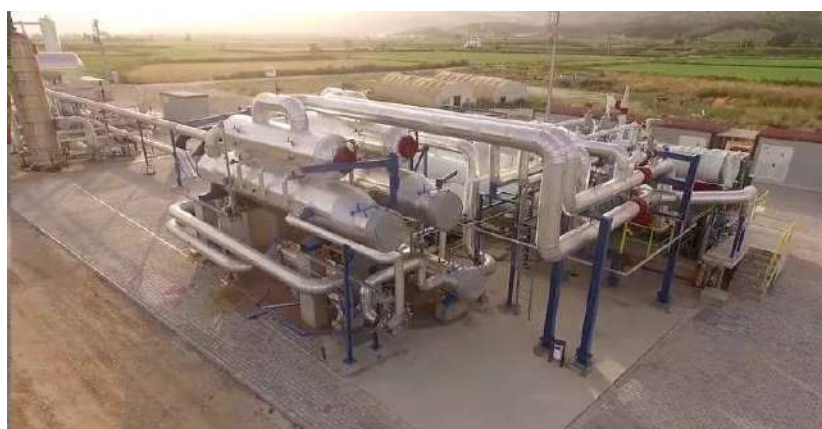
Figura 25. Impianto binario geotermico da 3,5 MW e installato a Denizli Tosunlar, Turchia (fonte: Exergy s.p.a.)
