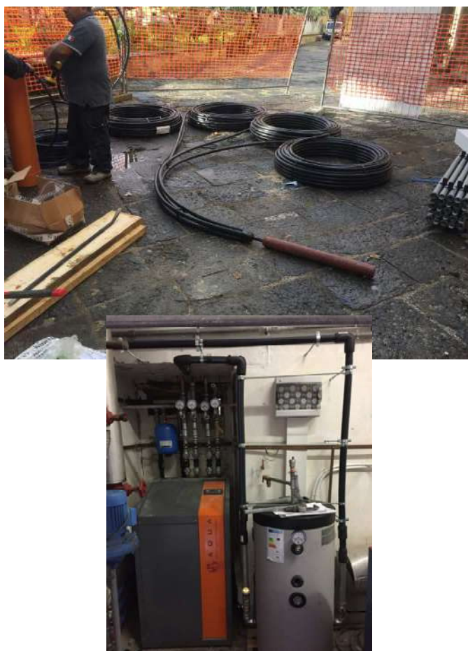
Figura 33 Pompa di calore geotermica con sonde verticali installate presso il sito dimostratore di Largo San Marcellino- Napoli (fonte:Craveb)
