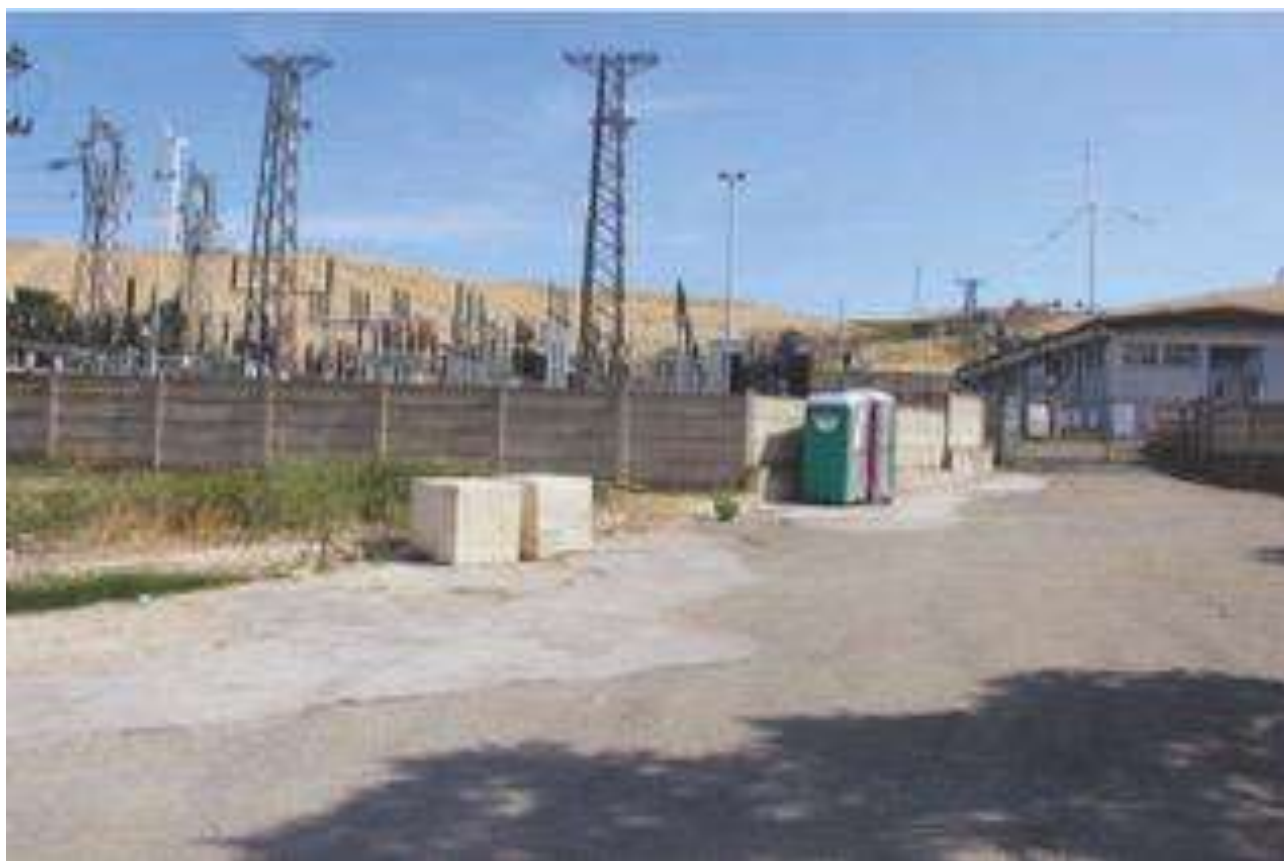
Figura 7 – Vista della Cabina Primaria di Lacedonia
