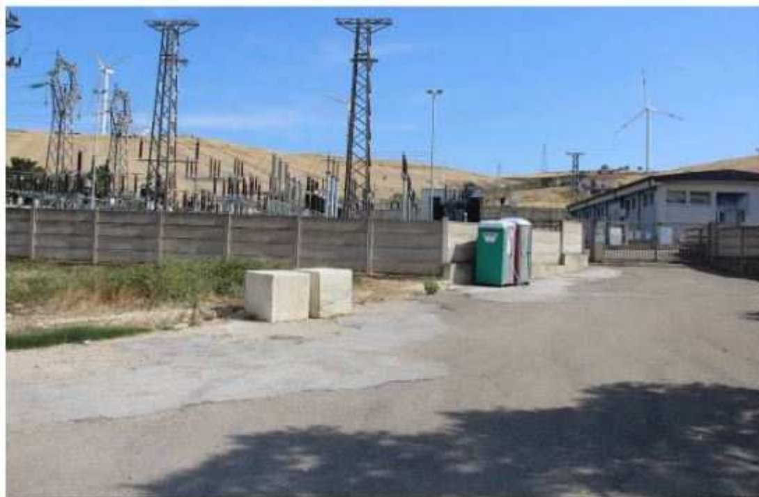
Foto 6. Vista della Cabina Primaria di Lacedonia
