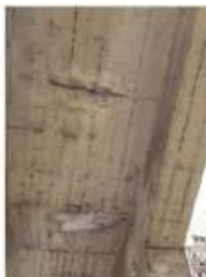
Scale: Ammaloramento del cls e ferri esposti
