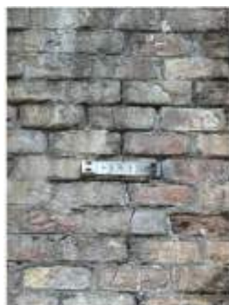
Volta campata I – Fessura lungo le giunzioni e nei mattoni – lato alveato settore volta lato Pozzoli
