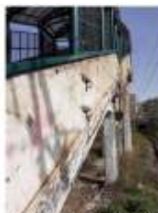
Scale: Ammaloramento del cls
