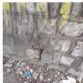
Figura 1.5 - Detrimento elemento lapideo ai piedi della pile 7
