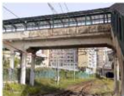
Passerella: Ammaloramento del cls
