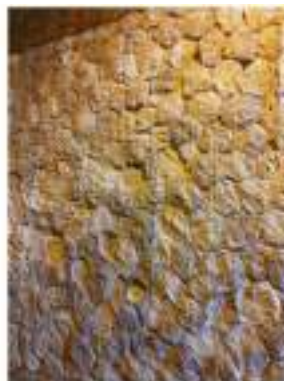
Figura 1.4 - Spalle: deterioramento della ristilatura nelle giunture nonché disgregazione degli elementi
