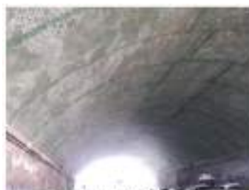
Volto - Particolare fessura di volta
