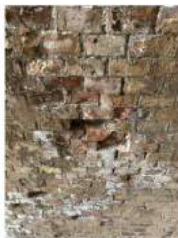
Volta rampa 3 - elementi di muratura rotti
