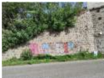
Figura 1.4 - Intorno a forte vegetazione a lungo dei muri d'ala
