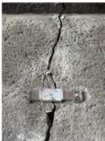
Spalla 2 - Fessura alla pietra consolidata con fissaturino
