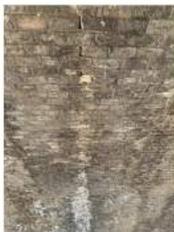
Volta rampa 2 - fessure lungo le giunzioni setti e cordolo
