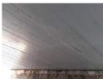
Figura 1.3 - Infiltrazioni lungo i giunti d'impalcata
