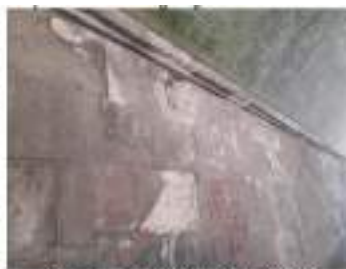
Spalla 2 - Elementi in pietra esfoliati/sfaldati
