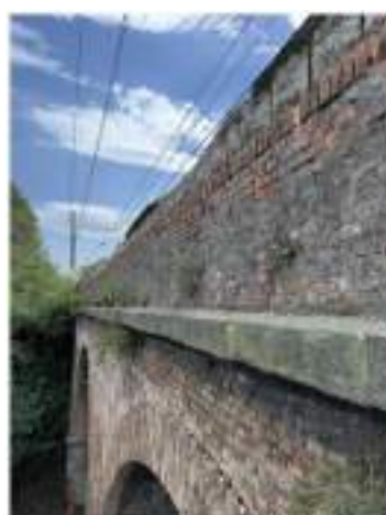
Parapetto - presenza di cricche nelle giunzioni e cordolo in c.a. degradato
