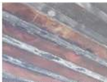
Spalla 2 - Profilo di varco preesistente con esfoliazione e perdita di spessore lungo le travi incoerenti
