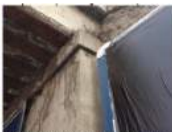
Spalla 2 - Infiltrazioni ed efflorescenze sulle spalle e l'impalcato
