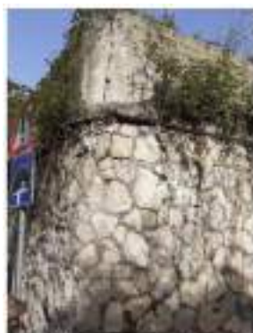
Figura 1.5 - Lesione del muro d'ala di Spalla 1
