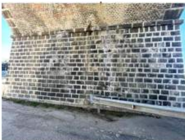
Pila - Macchie d'umidità e percolazione acqua
