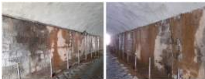
Spalla 1: Infiltrazione attraverso la muratura
