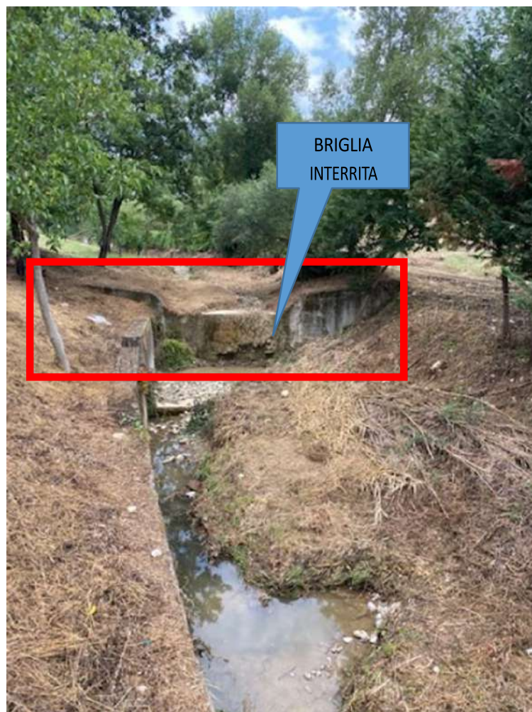
Briglia in calcestruzzo interrta
