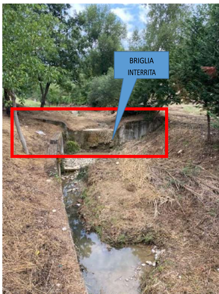
Briglia in calcestruzzo interrta
