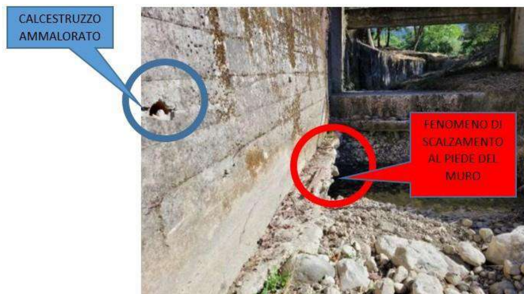
Calcestruzzo ammalorato e fenomeni di scalzamento (cono ottico 5)
