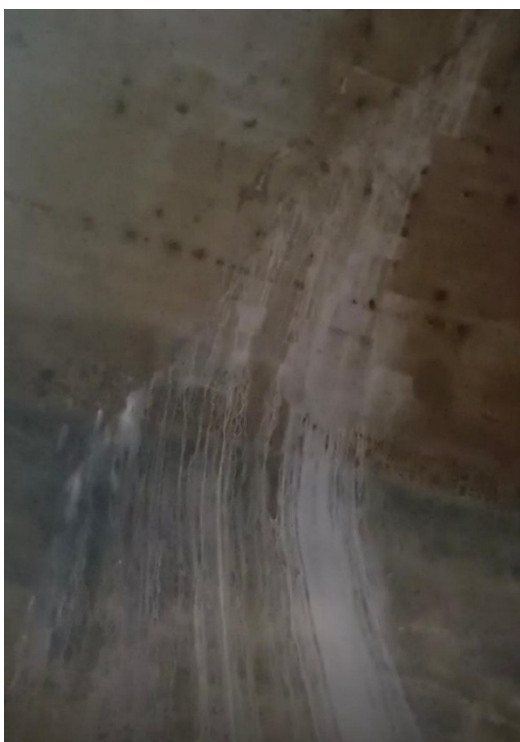
Quadro fessurativo latero superiore
