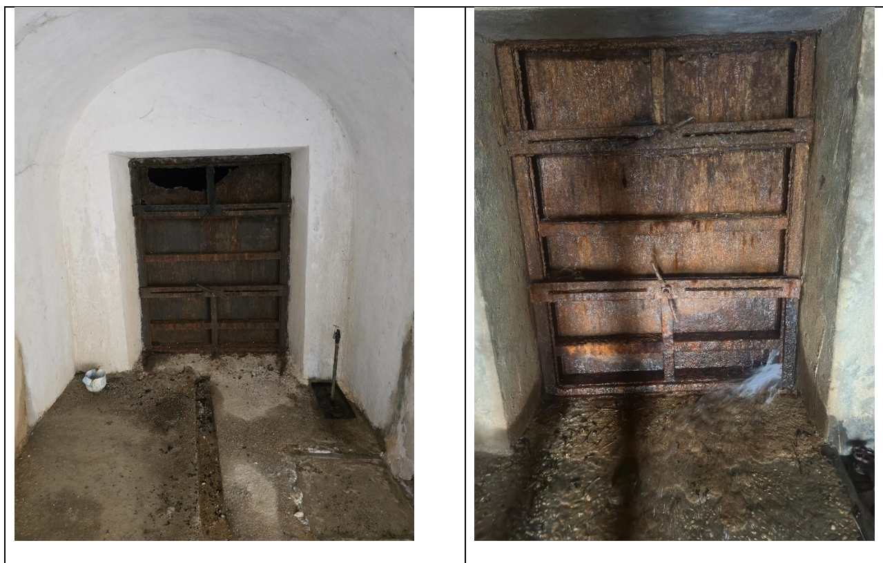
Figura 7: Porte Stagne. Colle Ducito (a sx): si nota corrosione della parte alta. San Potito Sannitico (a dx): si nota una perdita in basso
