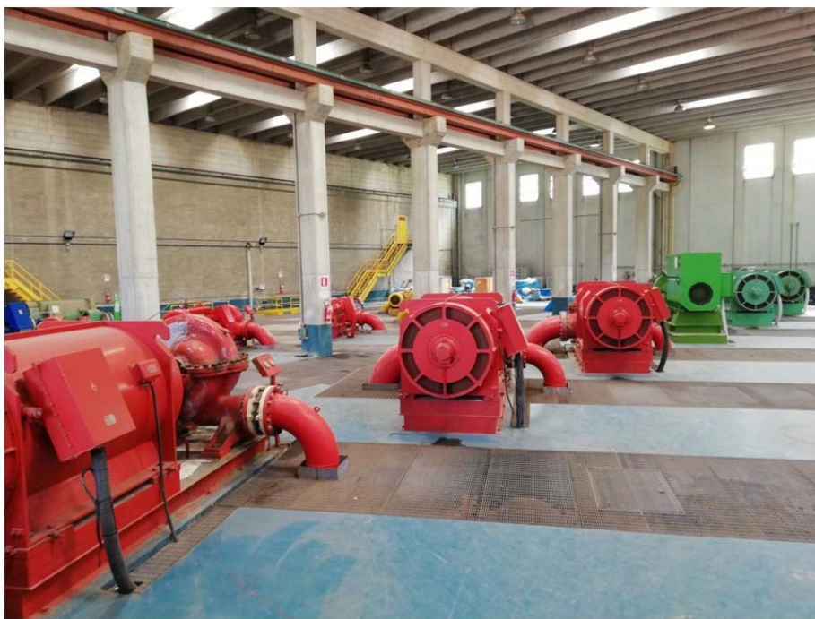
Figura 3- Fila est (in primo piano) e ovest (in secondo piano) delle pompe di sollevamento di Cancellò
