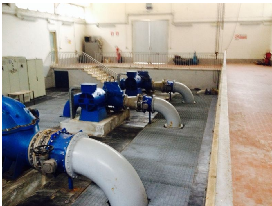
Figura 6: Centrale di sollevamento Maretto
