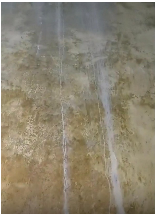
Quadro fessurativo laterale
